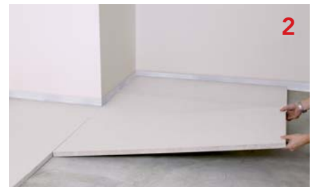
Die Verlegung der Wärme-/Trittschalldämmung erfolgt auf besenreinem Untergrund. Zur Auswahl stehen verschiedene Materialien, z. B. Hanf oder Holzfaser, Mineralfaser (Stein-/Glaswolle) oder Polystyrol.
